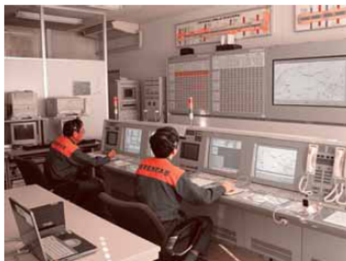
通信室内の状況
